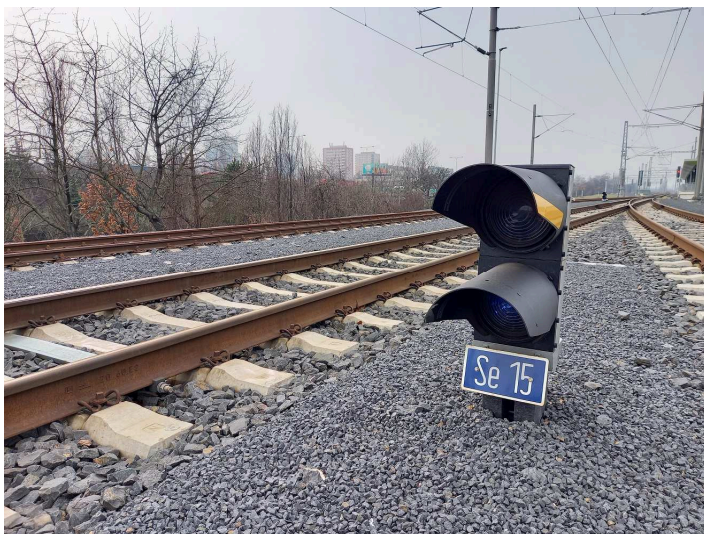
obrázek 213 – Světelné seřad'ovací návěstidlo trpasličí
