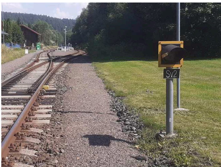
obrázek 164 – Světelné návěstidlo výhybky se samovratným přestavníkem
