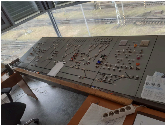
obrázek 432 – Ovládací stůl spádovištního zařízení s jednotlivě přestavovanými výhybkami (výkolejkami) pomocí radičů
