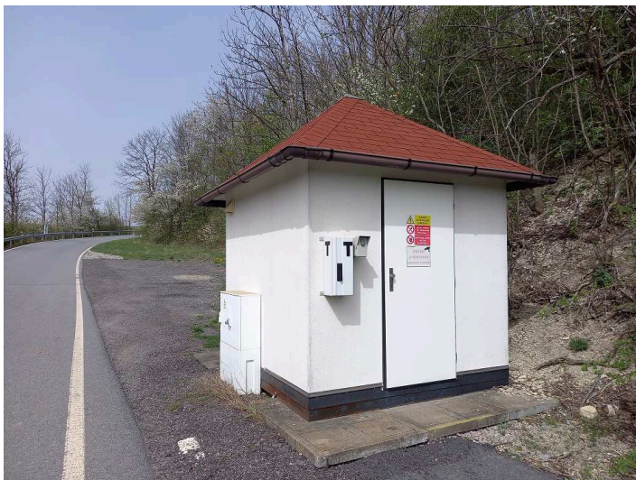
obrázek 416 – Reléový domek PZS (včetně skříňky místní obsluhy a venkovního telefonního objektu)
