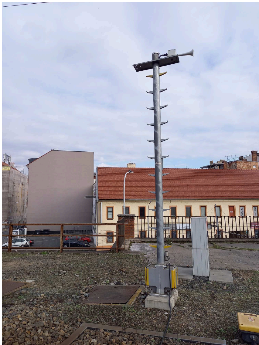
obrázek 236 – Siréna VNPN vnějšího provedení (VNPN – výstraha při nedovoleném projetí návěstidla)
