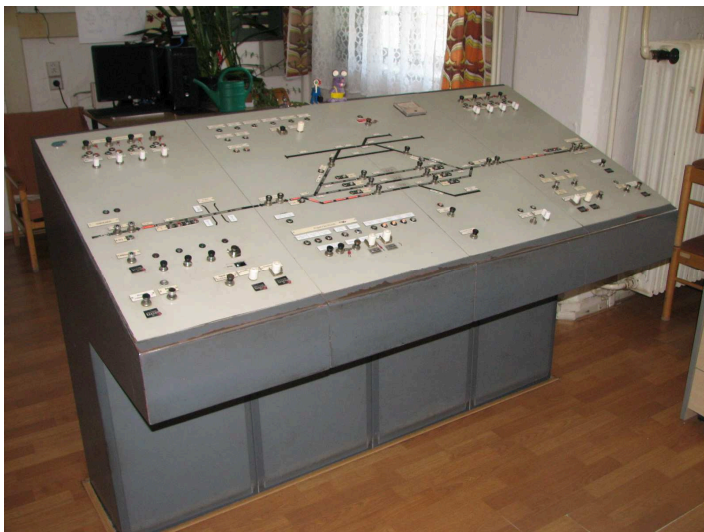
obrázek 355 – Ústřední stavědlo typového elektrického stavědla (dále jen „TEST“) s kolejovými úseky (dále jen „KÚ“) – ovládací stůl
