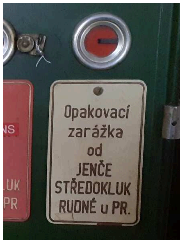
obrázek 321 – Opakovací zarážka (na řídícím přístroji)
