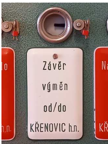
obrázek 318 – Výměnové hradlo (závěr výměn) na řídicím přístroji
