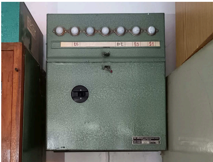
obrázek 315 – Skříňka soupravy pro elektrické osvětlení mechanických návěstidel
