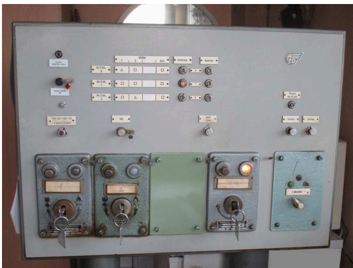
obrázek 361 – Závislé výhybkářské stanoviště SZZ TEST s řídicím stavědlem a závislými výhybkářskými stanovišti
