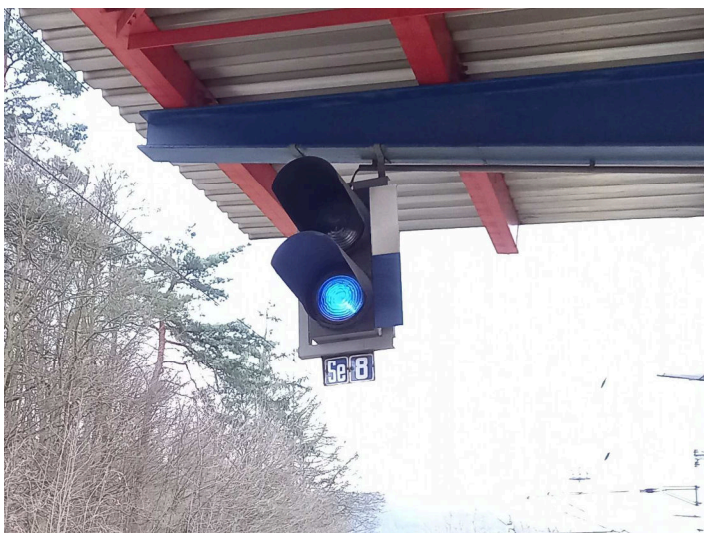
obrázek 214 – Světelné seřad'ovací návěstidlo stožárové (umístěné na konstrukci)
