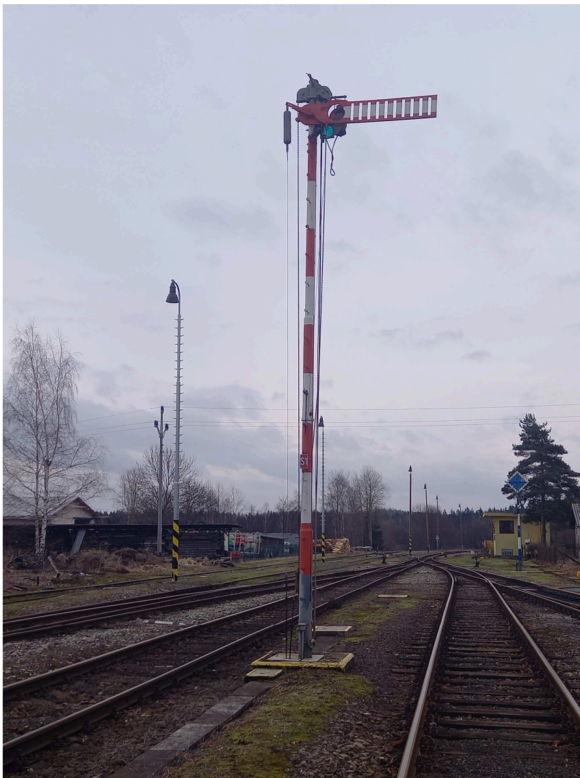
obrázek 196 – Mechanické hlavní návěstidlo jednoramenné
