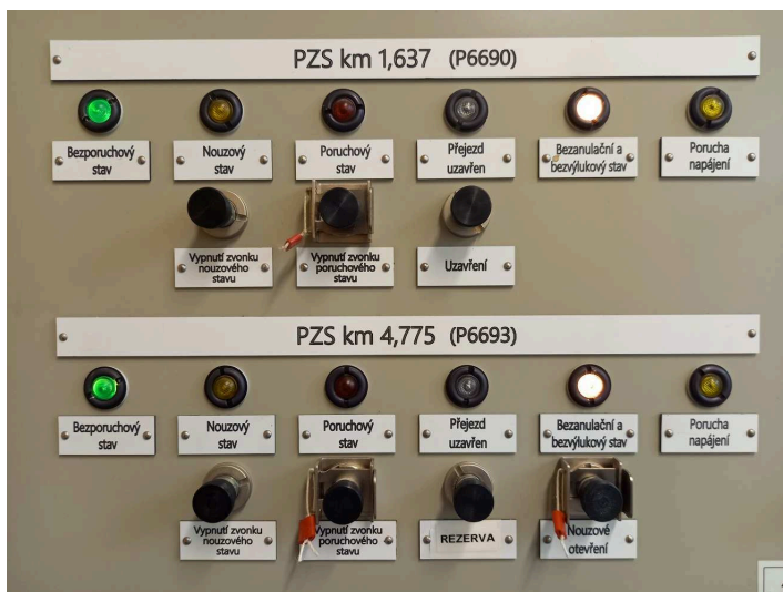
obrázek 413 – Ovládací skříňka PZS nově budovaných typů
