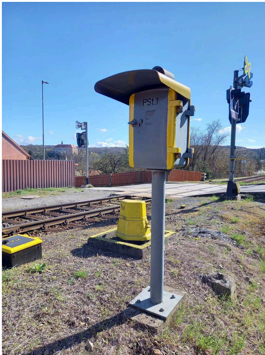
obrázek 220 – Pomocné stavědlo vnějšího provedení
