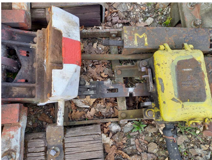
obrázek 152 – Elektrický výměnový zámek, pohled na kontrolní tyč výkolejky (mezi svodným klínem a elektrickým výměnovým zámkem)
