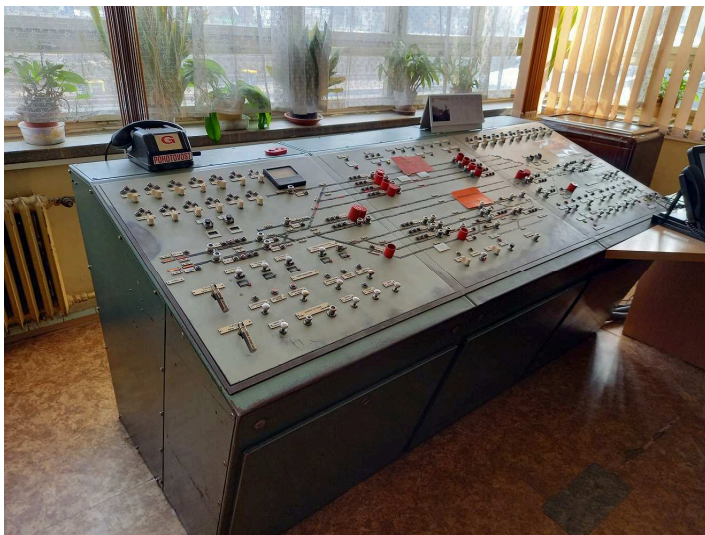
obrázek 338 – Ovládací stůl RZZ cestového systému se skupinově přestavovanými výhybkami (výkolejkami)
