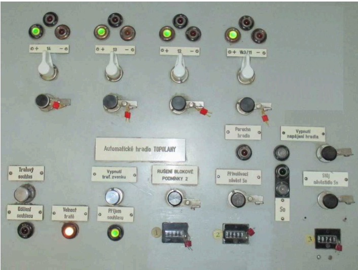
obrázek 385 – Ovládací a indikační prvky automatického hradla AH-83 s oddílovými návěstidly
