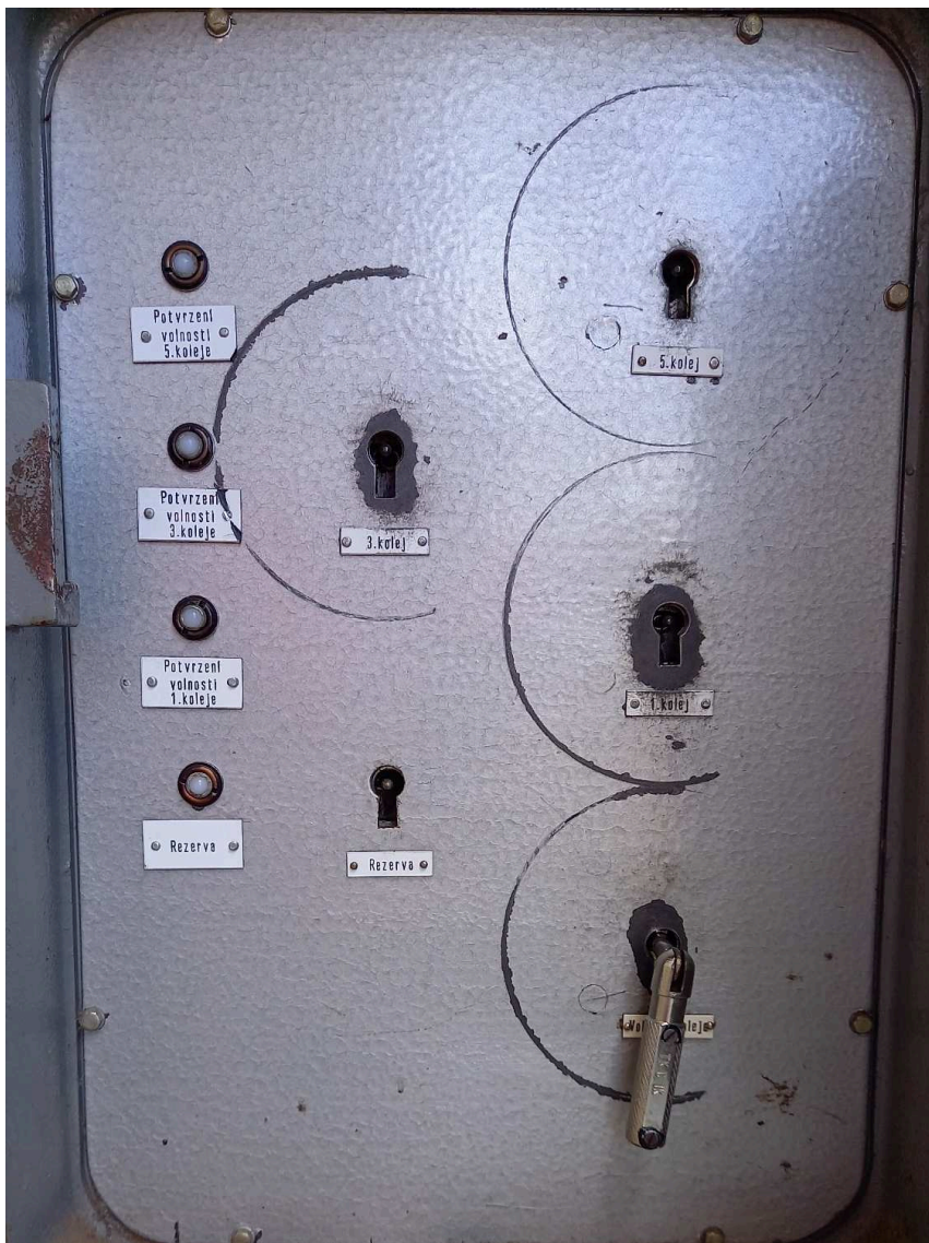
obrázek 359 – Zámky volnosti koleje (umístění v kolejišti v ovládací skříňce pomocného stavědla)
