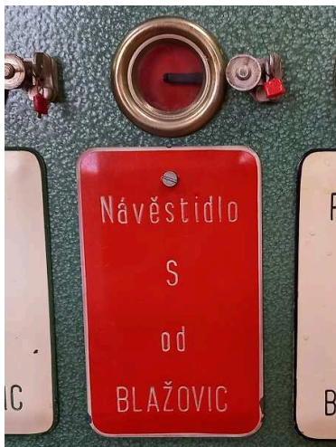
obrázek 316 – Návěstní hradlo na řídicím přístroji
