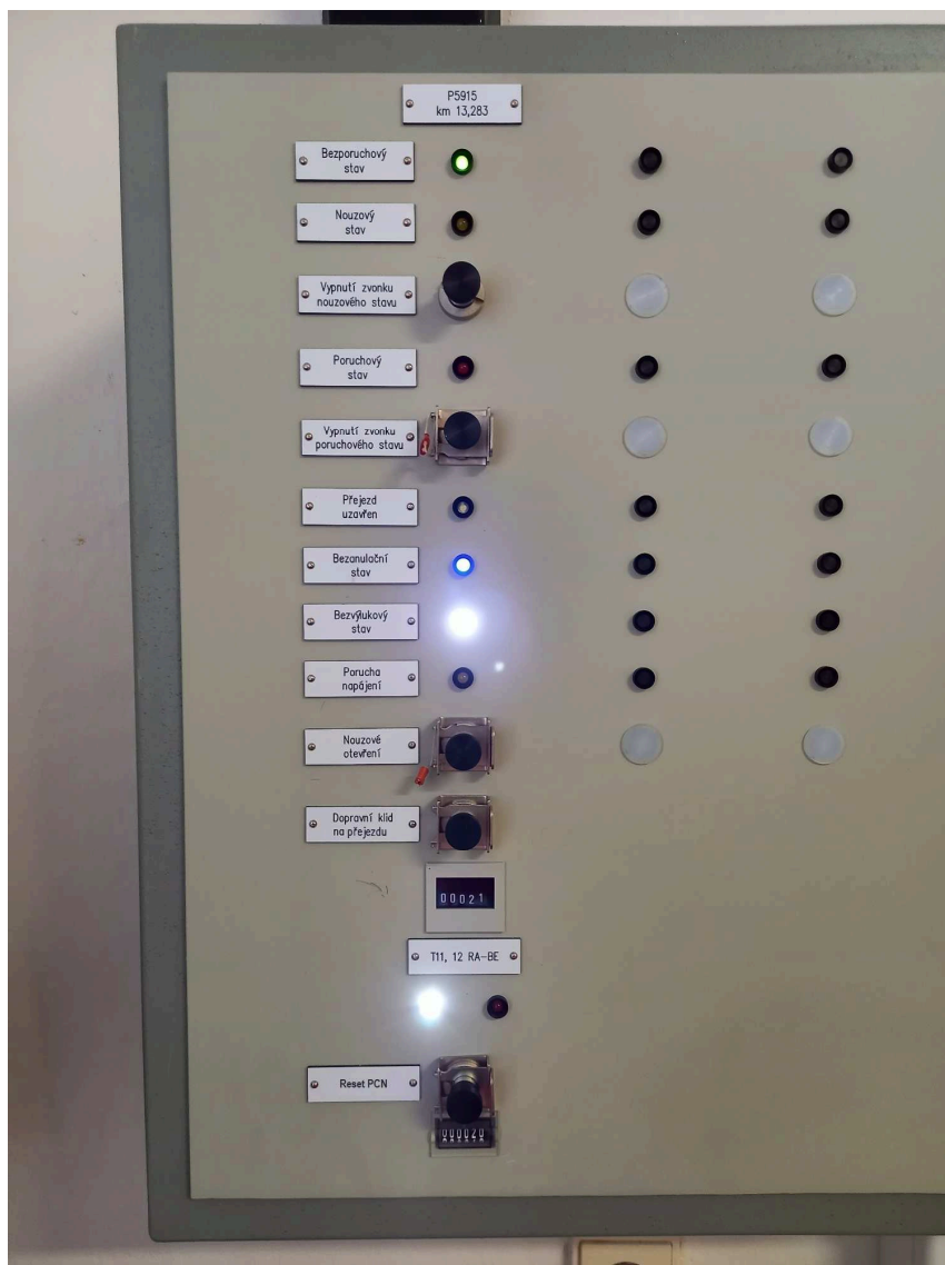
obrázek 412 – Ovládací skříňka PZS nově budovaných typů
