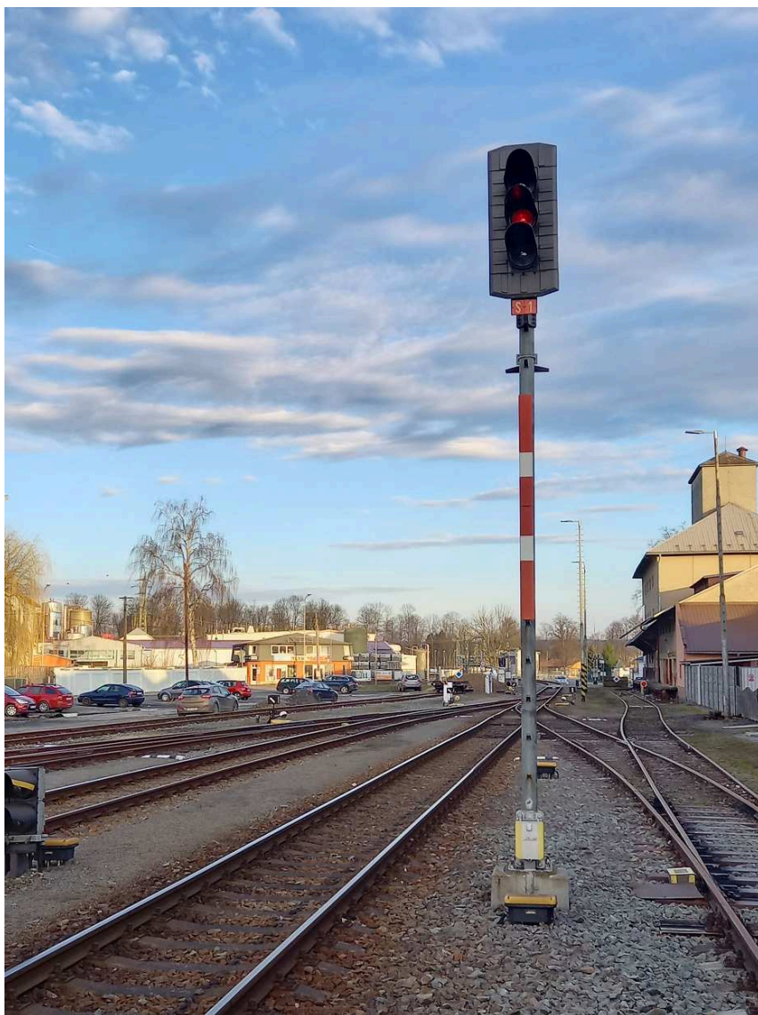
obrázek 205 – Světelné hlavní návěstidlo stožárové
