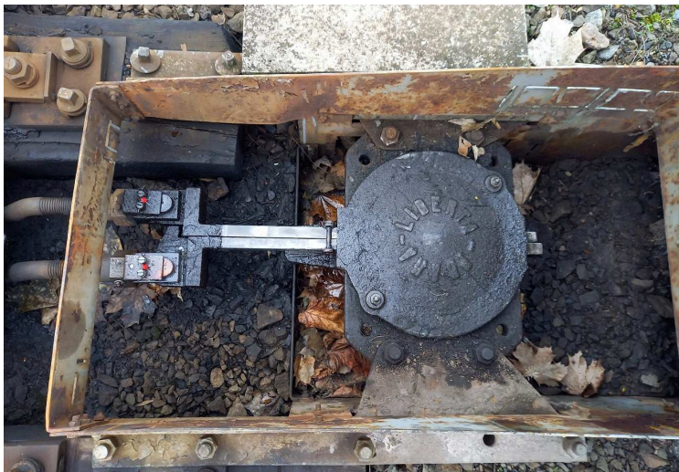
obrázek 182 – Mechanický záporník se dvěma závorovacími tyčemi (na výhybce)
