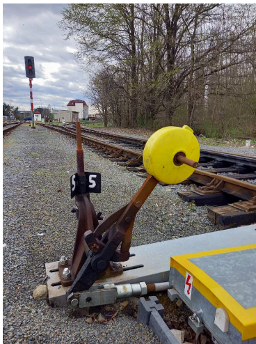
obrázek 80 – Výměník ústředně (místně) přestavované výhybky
