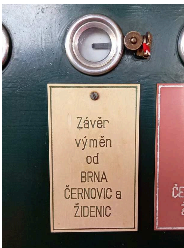
obrázek 319 – Výměnové hradlo (závěr výměn) na výhybkářském přístroji
