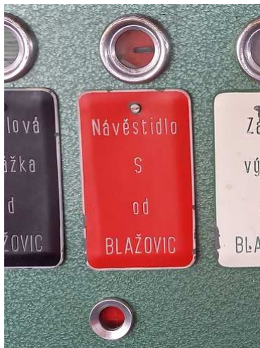
obrázek 317 – Návěstní hradlo na výhybkářském přístroji (s náhradní západkou)
