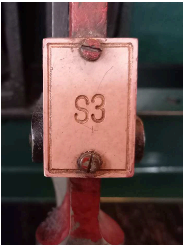
obrázek 265 – Příklad označovacího štítku návěstní stavěcí páky (hlavní návěstidlo)
