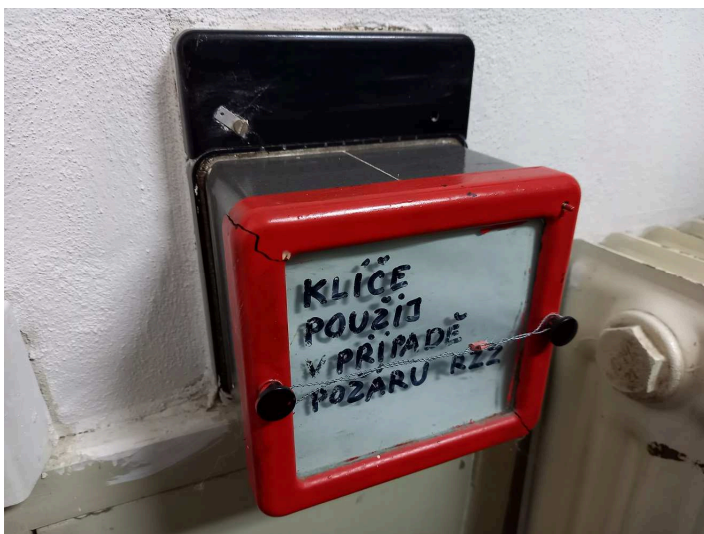
obrázek 31 – Náhradní klíče od stavědlové ústředny (plomba na drátu)
