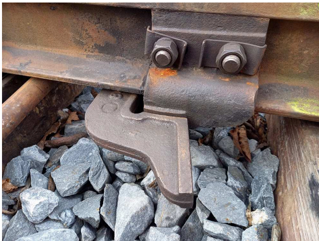
obrázek 44 – Úplné zaklesnutí hákového závěru u výhybky s hákovým závěrem
