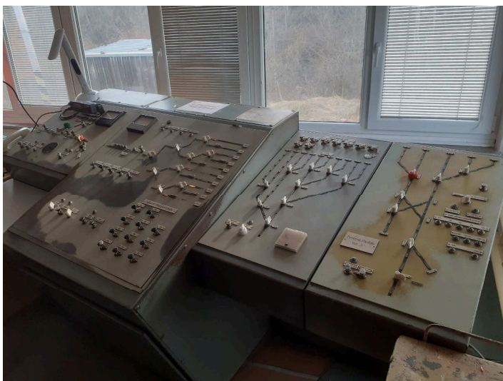
obrázek 433 – Ovládací stůl spádovištního zařízení s jednotlivě přestavovanými výhybkami (výkolejkami) pomocí radičů
