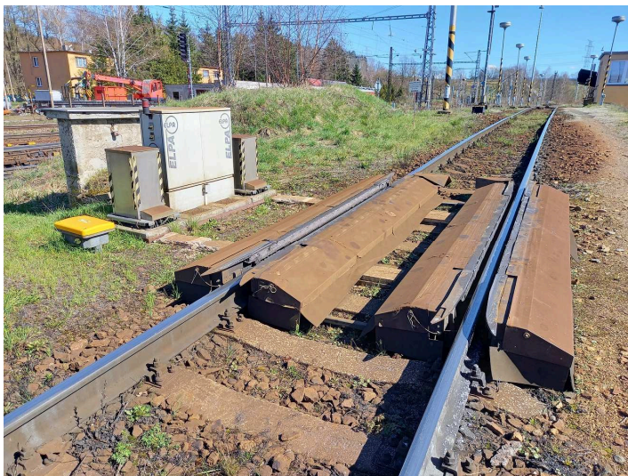
obrázek 441 – Zařízení pro mazání bočních brzdných kol dražních vozidel před dvoukolejnicovou brzdou
