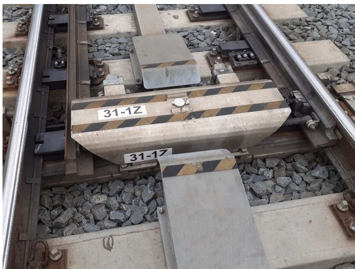
obrázek 178 – Hydraulický přestavník s vnitřním závěrem včetně krytu, ve výměnové části výhybky
