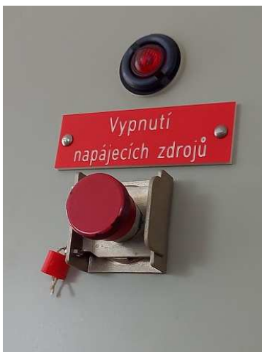
obrázek 21 – Tlačítko pro nouzové vypnutí napájení staničního zabezpečovacího zařízení (dále jen „SZZ“)
