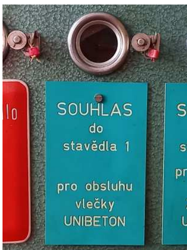
obrázek 322 – Výměnové souhlasové hradlo
