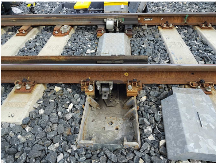
obrázek 78A – Žlabový pražec u výhybky s elektrickým přestavníkem
