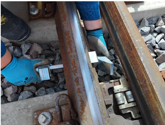
obrázek 142C – Zaklesnutí přední svěrky za patu kolejnice mezi jazyk a opornici
