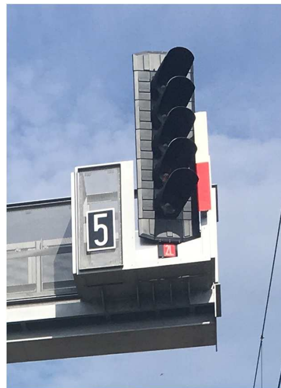
Krakorcové návěstidlo umístěné na krakorci
