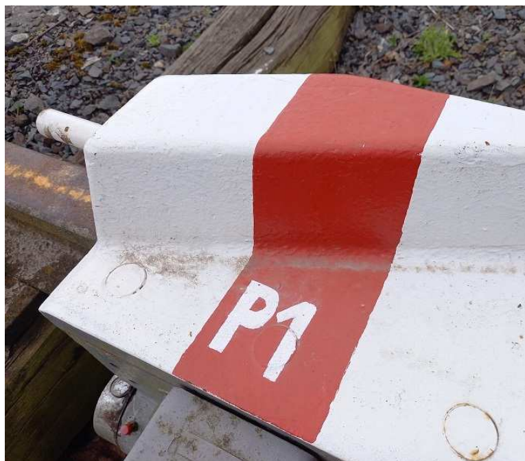
Označení výkolejky na svodném klíně
