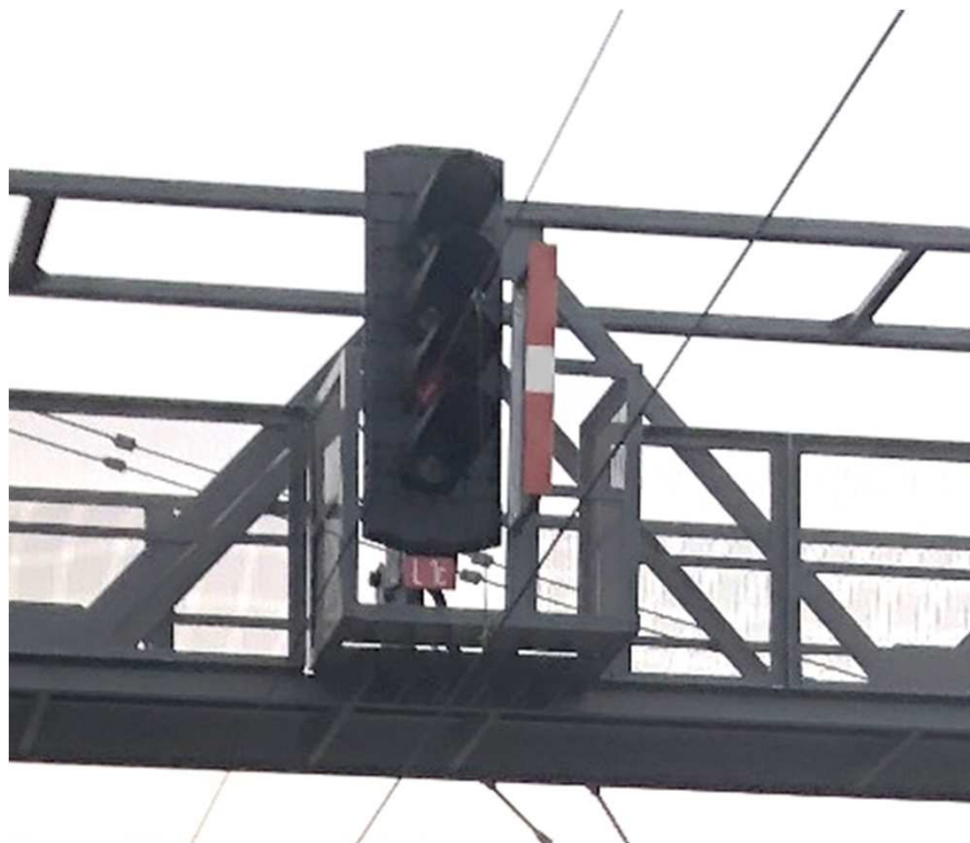
Krakorcové návěstidlo umístěné na návěstní lávce
