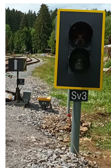
Světelné návěstidlo výhybky se samovratným přestavníkem
