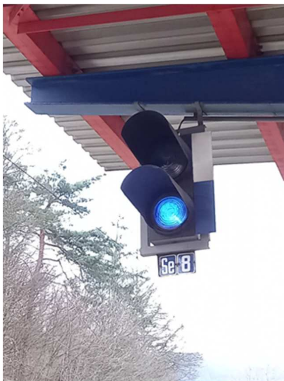
Stožárové návěstidlo umístěné na střeše nástupiště
