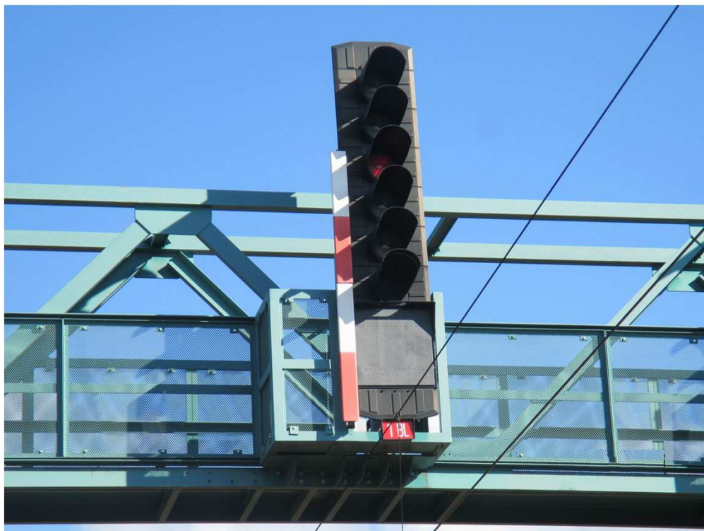
Krakorcové návěstidlo umístěné na návěstní lávce (příklad provedení označovacího pásu není v souladu s normou TNŽ 34 2605)
