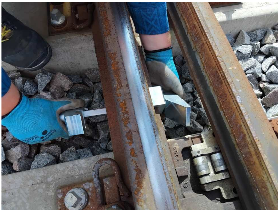
Zaklesnutí přední svěrky za patu kolejnice mezi jazyk a opornici
